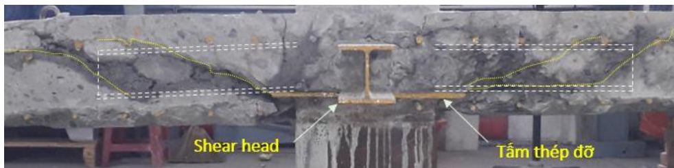
Hình 2.4. Trạng thái nứt trên mặt cắt 1-1 (vùng A), 2-2 (vùng B)
